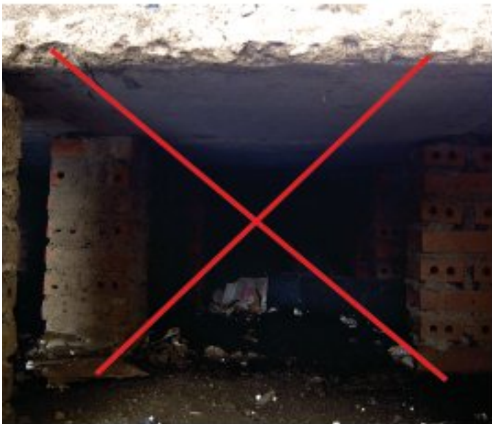
ĐÁY SÀN BẰNG GẠCH KHÓ SỬA CHỮA KHÔNG DI CHUYỂN ĐƯỢC
