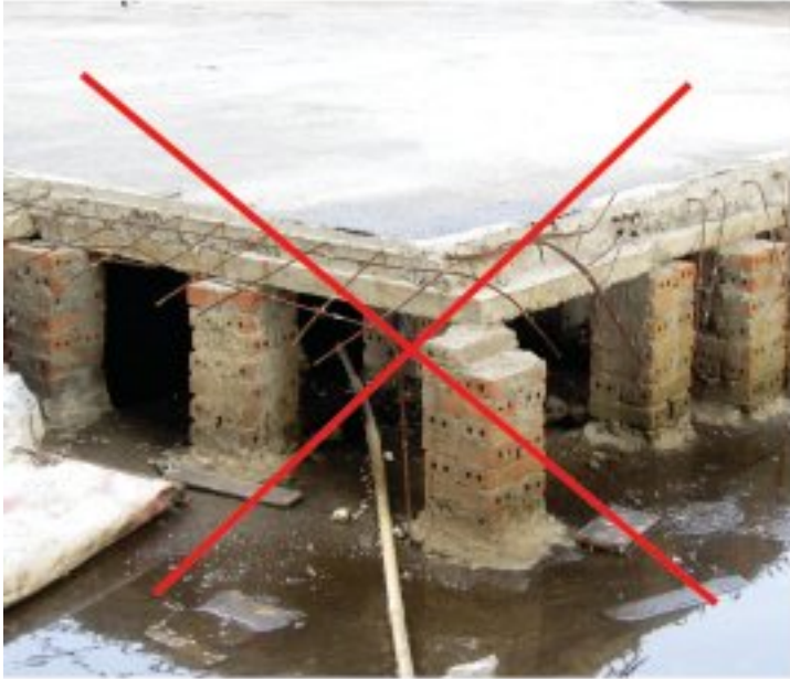
TRỤ NÂNG SÀN BẰNG GẠCH THI CÔNG PHỨC TẠP
